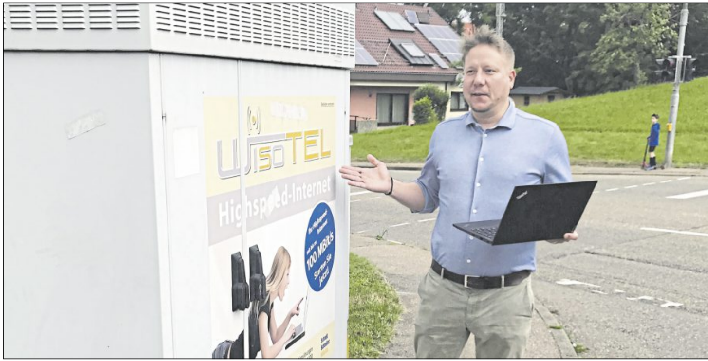
Fabian Schatton von Wisotel am Kabelverzweigerkasten beim Wohngebiet Hummerholz in Weiler zum Stein. Die 100 Mbit/s, mit denen damals als „Highspeed-Internet“ geworben wurde, reichen heutzutage nicht mehr aus und deshalb wird nun ausgebaut für Gigabit-Datentransfer. Foto: Speiser
